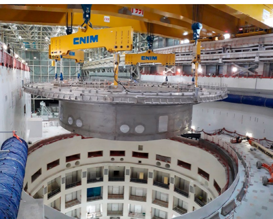
Manutention de la base du cryostat, la pièce la plus lourde d'ITER avec ses 1250 tonnes.
